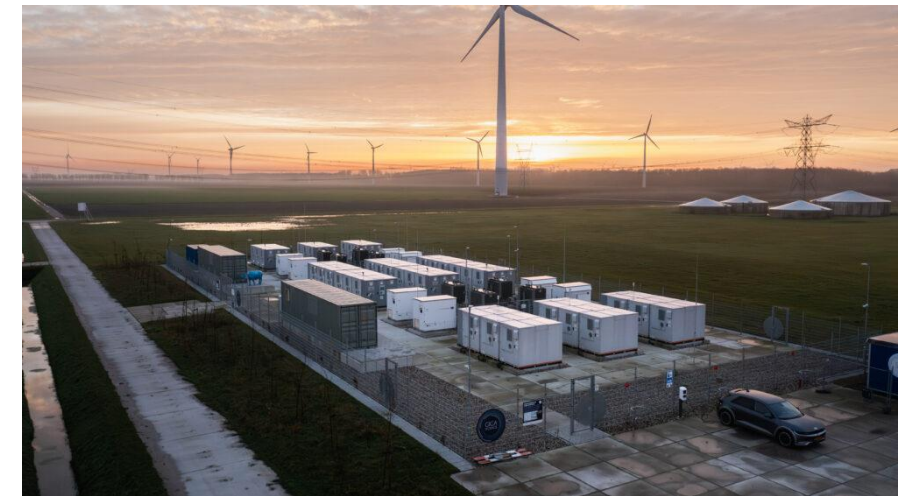
Figuur 4: Batterij park met een vermogen van 24 MW en 48 MWh aan opslag capaciteit 1
