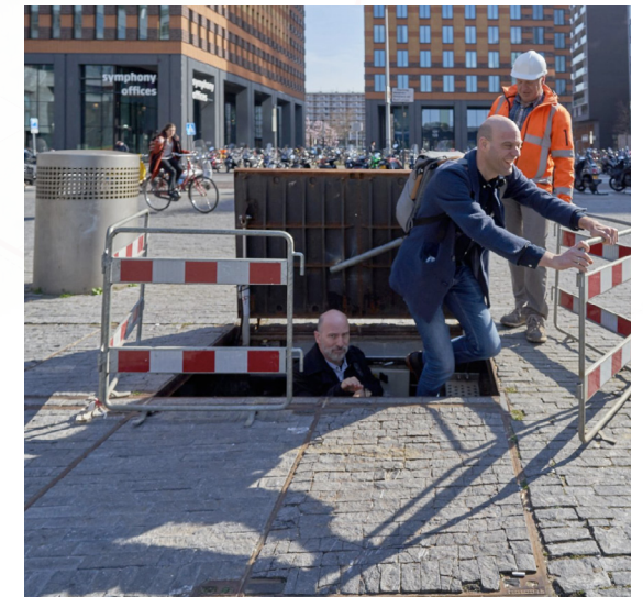
Integrale leidingen tunnel, Zuidas, Amsterdam
