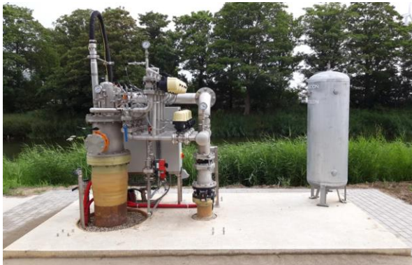
Figuur 12: HTO installatie Middenmeer 2 .
